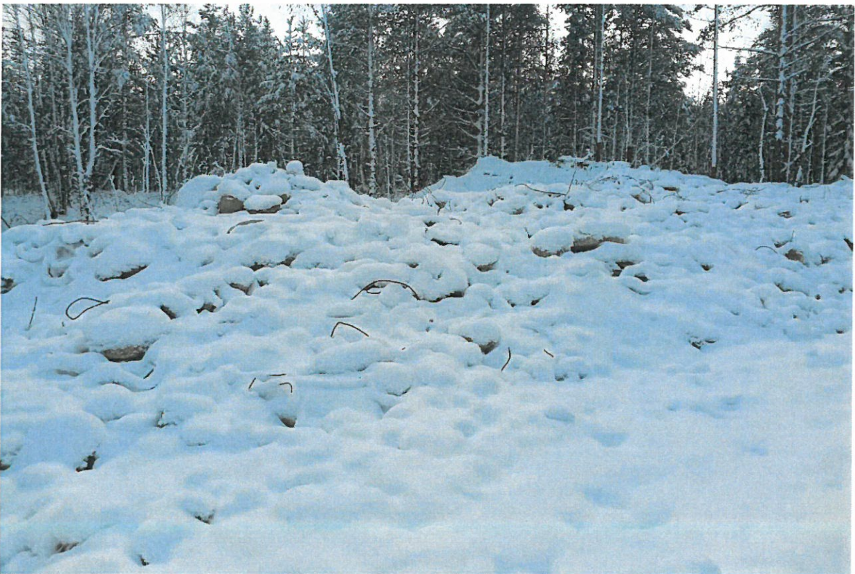
Kuva 1. Lumen peittämää purkubetonia ja rautoja kiinteistöllä 320-412-4-4.
