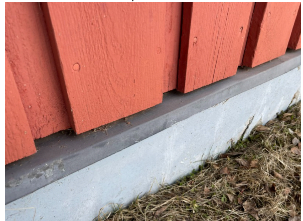
17. Julkisivun tuuletus puutteellinen.
