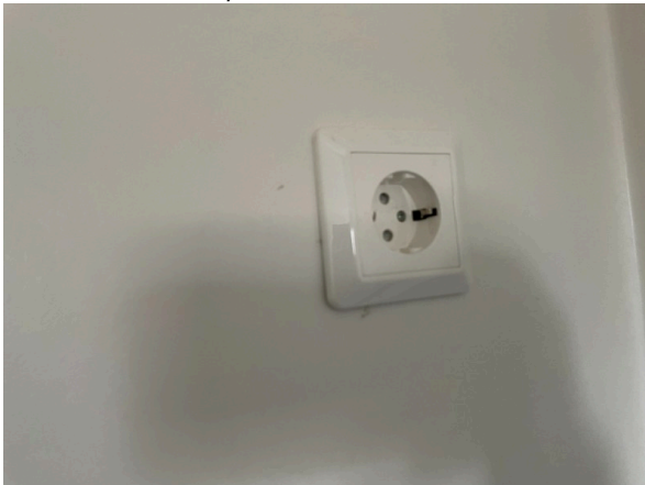
67. Huoneiston 1 luokan pistorasioita. (märkätila)
