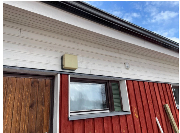
57. Rakenteisiin asennettu valaisin.
