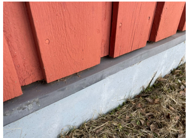
4. Maanpinnan korkeusero vierustoilla ulkoseinärakenteen alaosaan nähden on riittämätöntä.
