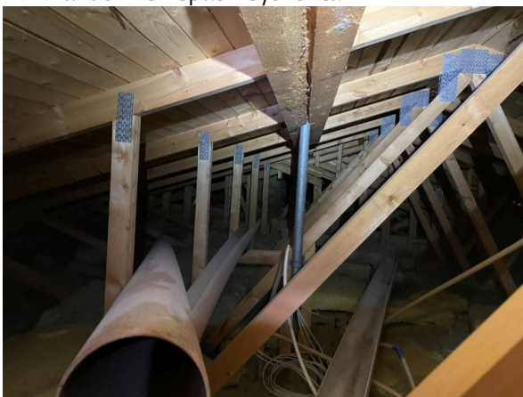
29. Yläpohjatilassa sinne kuulumatonta tavaraa.
