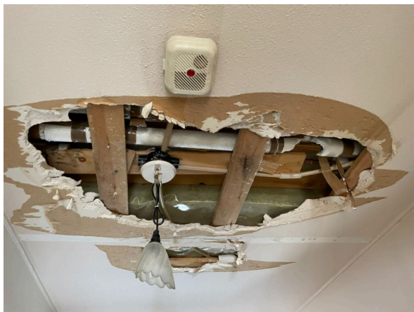
1. Kosteuden aiheuttama vaurio. as. 1.
