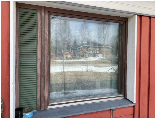
18. Ikkunoiden ulkopinnoissa on havaittavissa kulumista.
