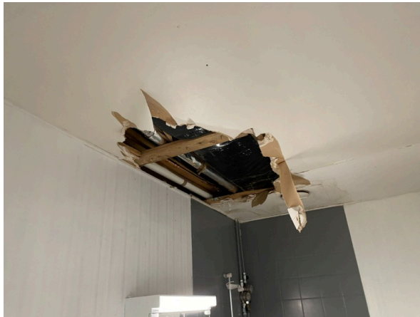
32. Alkuperäinen pesuhuone jossa ollut putkivuoto katossa.
