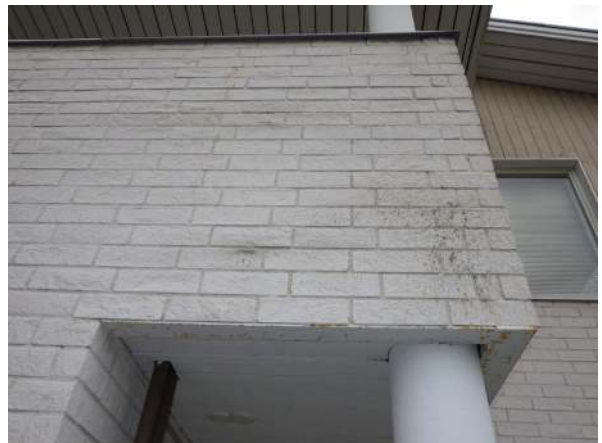
26. Julkisivun teräsosissa ruostetta
