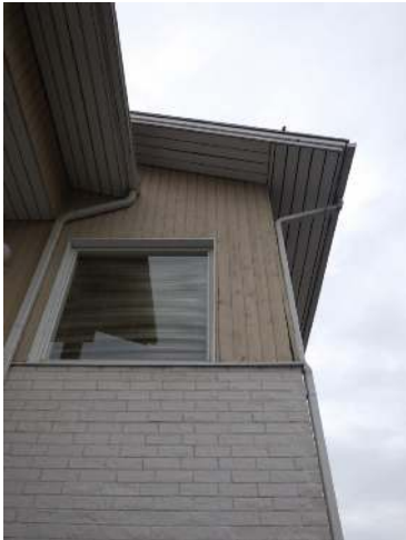
27. Nurkkalauta haljennut puuverhouksessa
