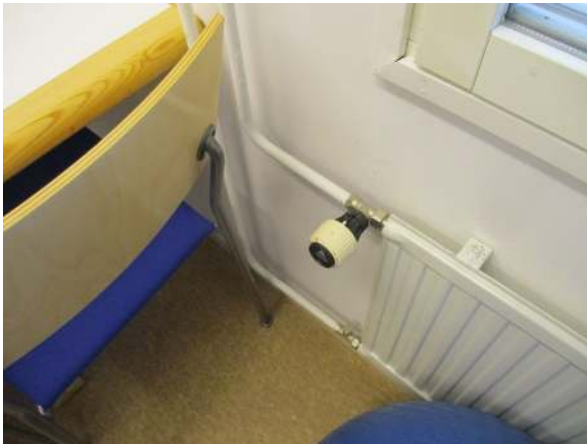
83. Patteriventtiilit ovat pääosin alkuperäisasennuksia
