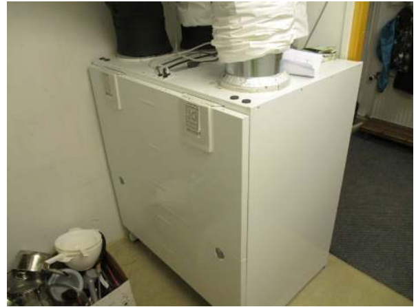
113. Koulukäyttömuutoksissa lisätty ilmanvaihtokone
