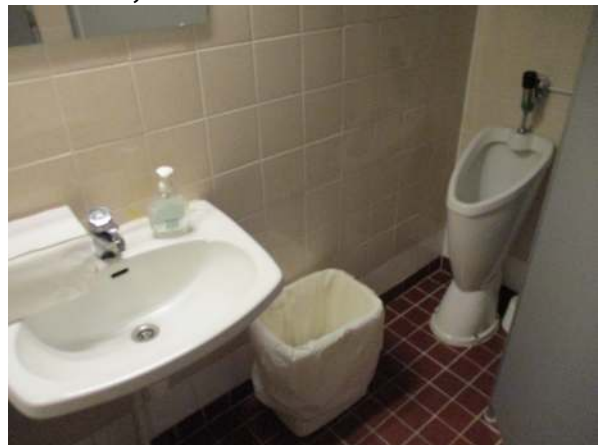
103. Vesi- ja viemärikalustusta
