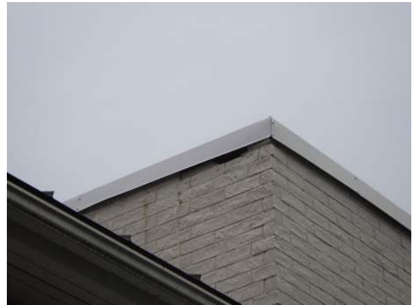
30. Korkeanosan suojapellityksen ja tiiliverhouksen välissä aukko.
