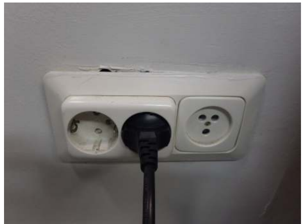
143. Huonosti tiivistetty pistorasia luokassa 130.
