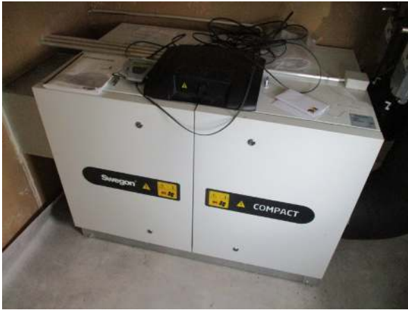
112. Koulukäyttömuutoksissa lisätty ilmanvaihtokone
