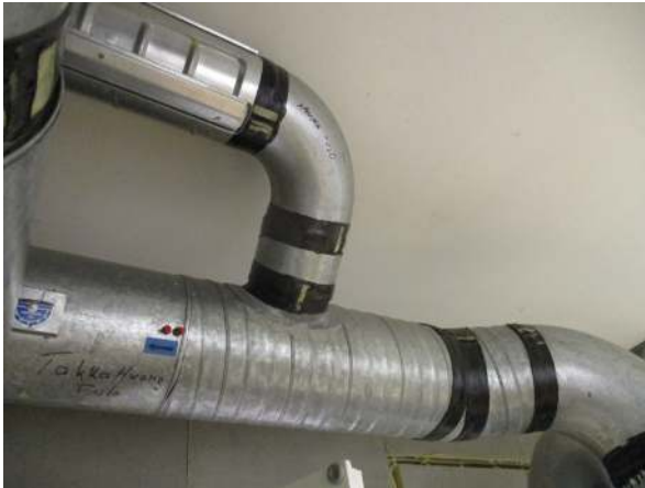
118. Alkuperäistä ilmanvaihtokanavointia varusteineen
