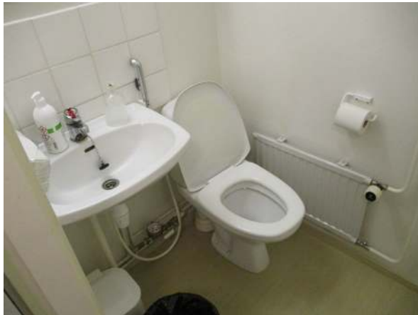
100. Vesi- ja viemärikalustusta
