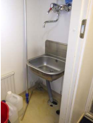
3. Kosteusjälki takapihan puoleisen tuulikaapin viereisessä siivouskomeron seinän alanurkassa. Tarkastushetkellä pinnat kuivia.
