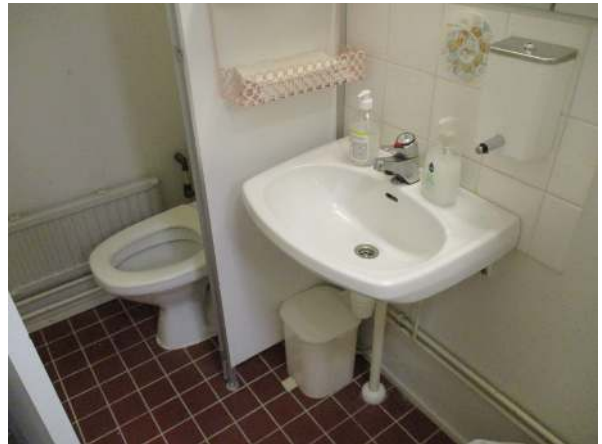
101. Vesi- ja viemärikalustusta
