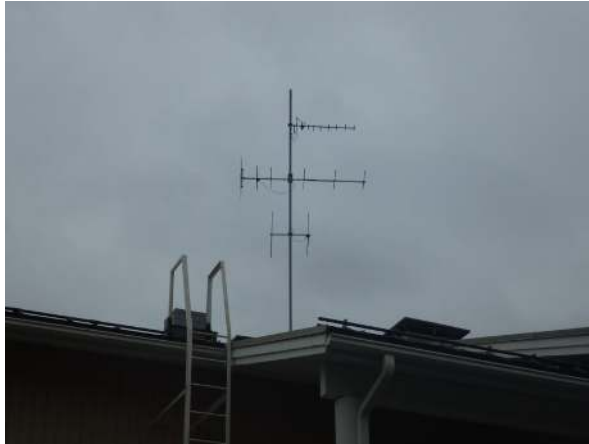
160. Vastaanottoantenni rakennuksen katolla.
