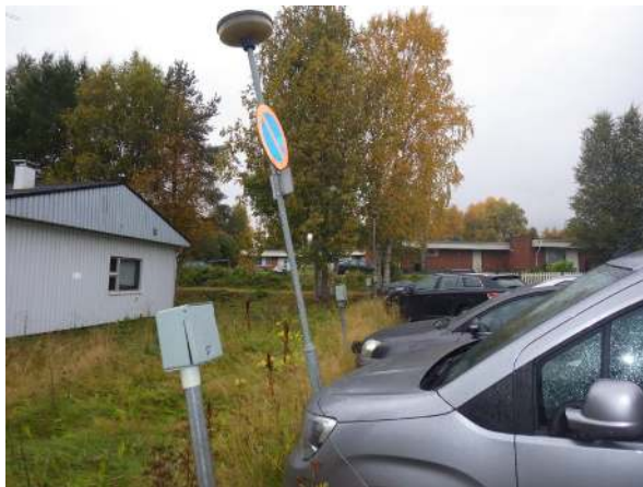
130. Autolämmityspistorasioita (tolpat ja pylväs oikaistava).
