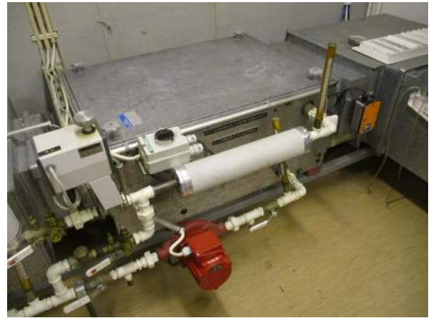
107. TF-2, saunaosaston tuloilmakone
