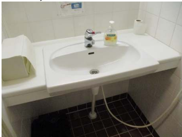
102. Vesi- ja viemärikalustusta
