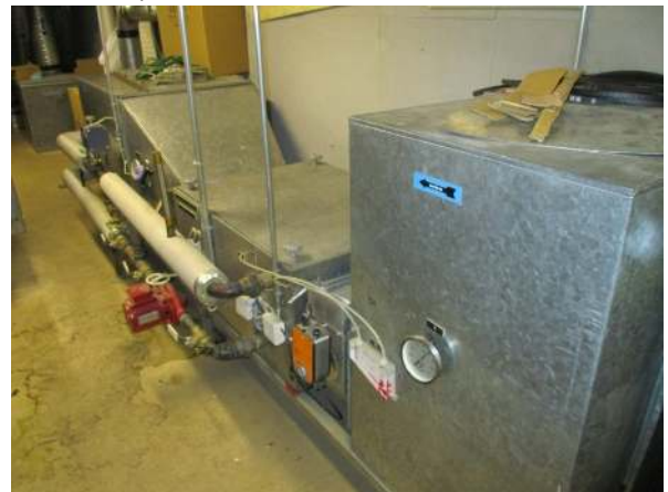
109. TF-4, keittiön tuloilmakone
