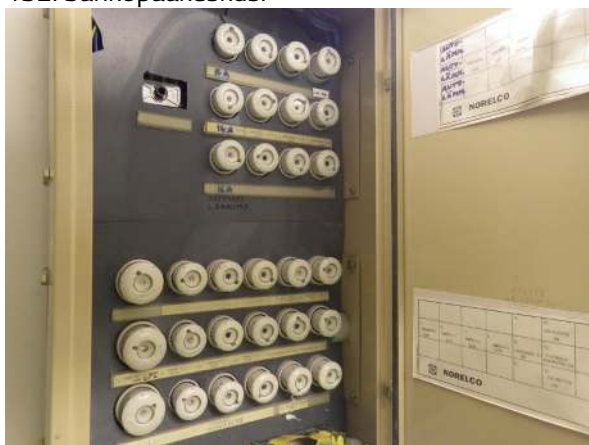
134. Jakokeskuksen JK 1.8. kosketusjännitesuojaus puutteellinen.
