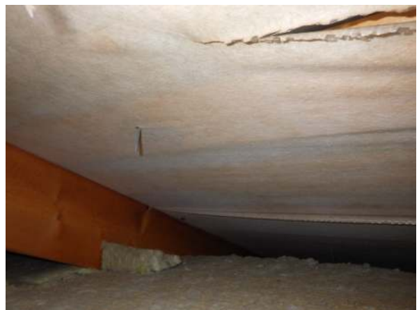
47. Naula lävistää aluskatteen ja aluskatteessa repeämä
