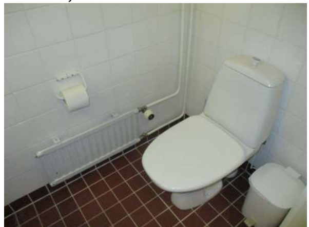
105. Vesi- ja viemärikalustusta
