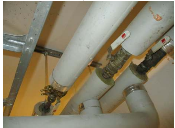
94. Vesijohdot venttiileineen ovat perusrungoltaan alkuperäisiä
