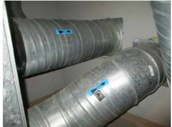
119. Alkuperäistä ilmanvaihtokanavointia varusteineen
