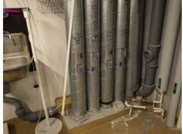
4. Lattiasa kosteus koholla ja vuotojälkiä IV-konehuoneessa (232) Lattialäpivientien kohdalla.
