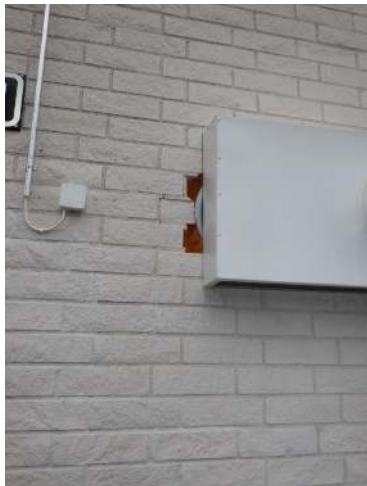
23. Läpivienti saumaamatta ja tiilisauma irti
