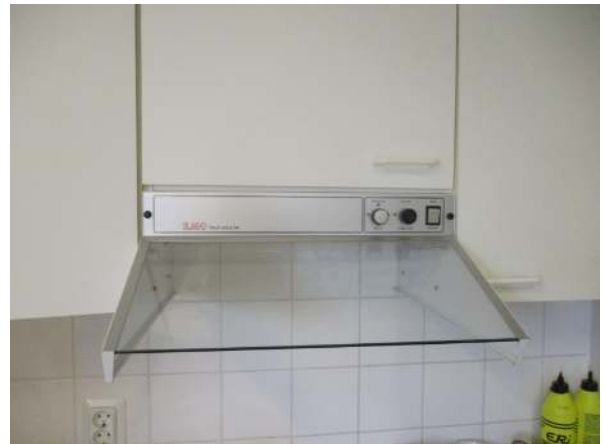
111. Päiväkotitilasta on poistoilmanvaihto talotuulettimella
