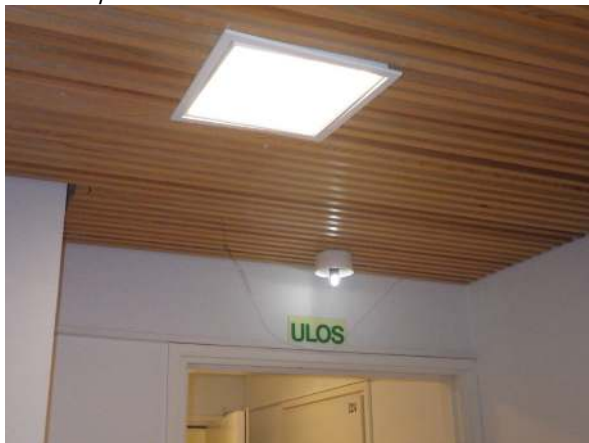
146. Uusittu valaisin, jonka kehys on irtoamassa (rikkoutunut poistumistievalaisin ovella).
