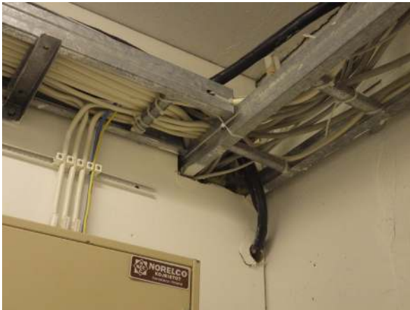
140. Avoin kaapeliläpivienti pääkeskuksillassa.
