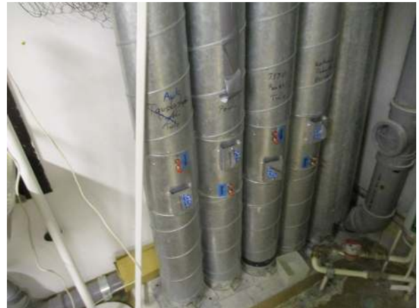
121. Alkuperäistä ilmanvaihtokanavointia varusteineen
