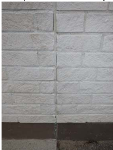
25. Julkisivu saumaus irti
