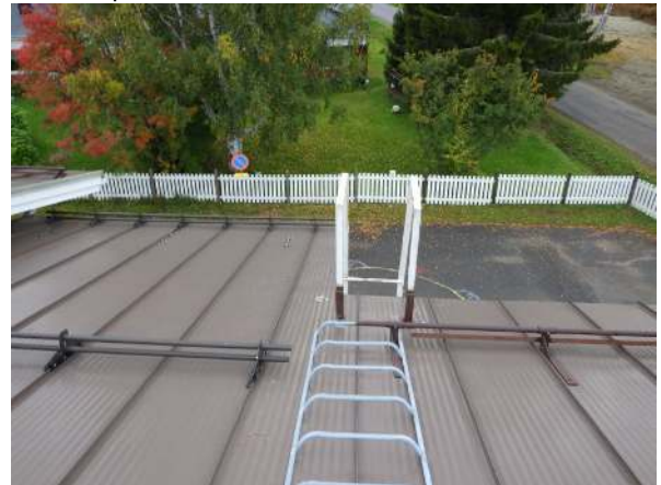
53. Tikkaat ruosteessa yläpäästä.
