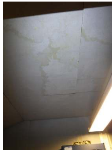
6. Kosteusjälkiä yläpohjassa 2krs. ullakkotilassa olevassa IV-konehuoneessa.
