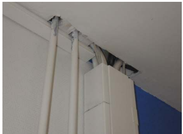
139. Johtokouru (tiivistys puutteellinen).
