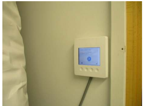
115. Lisätyjä ilmanvaihtokoneita ohjataan niiden yhteydessä olevista käyttöpäätteistä
