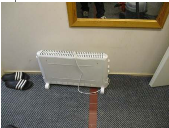
85. Tarkastuskierroksella havaittu lisälämmitin
