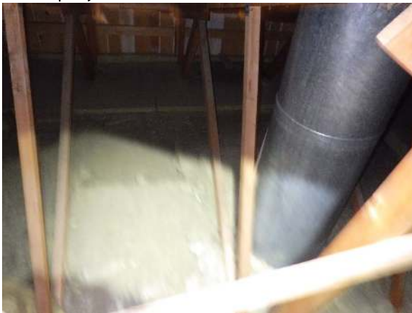
50. Eristämätön IV-kanava yläpohjatilassa
