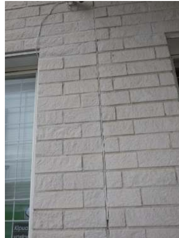
28. Julkisivu saumaus irti
