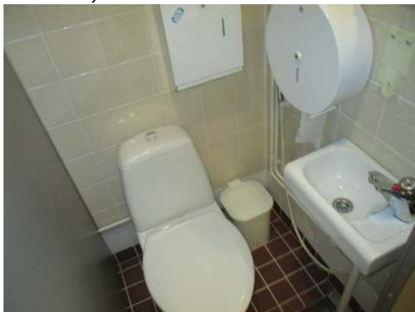
104. Vesi- ja viemärikalustusta
