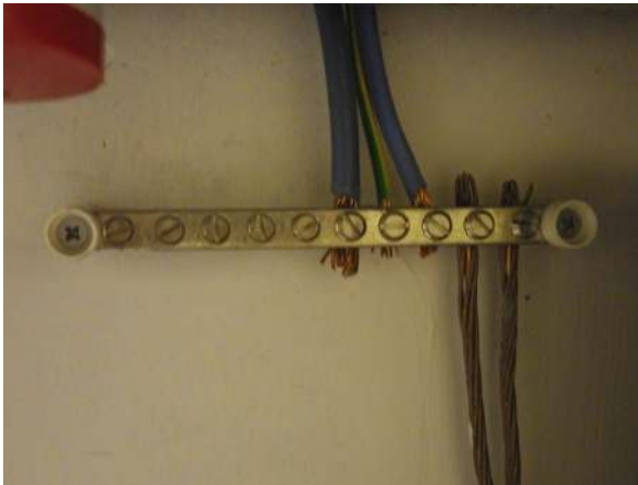
136. Päämaadoituskisko (johtimien merkinnät puuttuvat).
