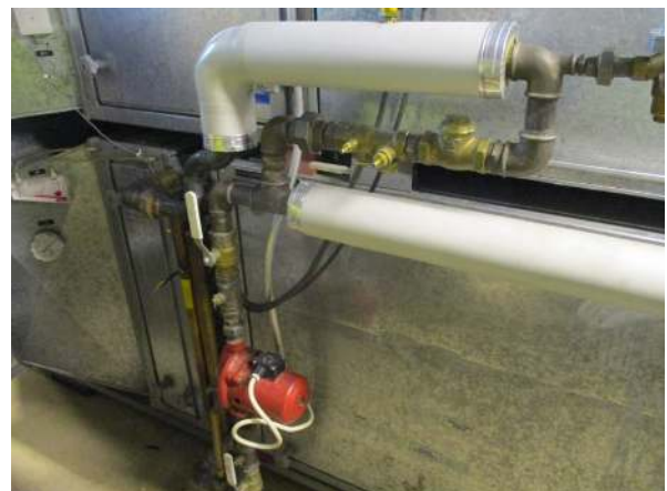
76. Kiertovesipumppu ja venttiileitä IV-lämmitysverkostossa
