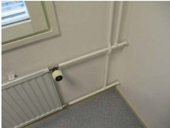
73. Lämpöjohdot ovat alkuperäisasennettuja teräsputkia
