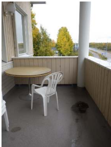
43. Roskaa parvekkeen vedenpoistossa
