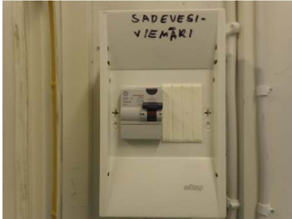
152. Sadevesiviemäreiden lämmityksen vikavirtasuojakytkin.
