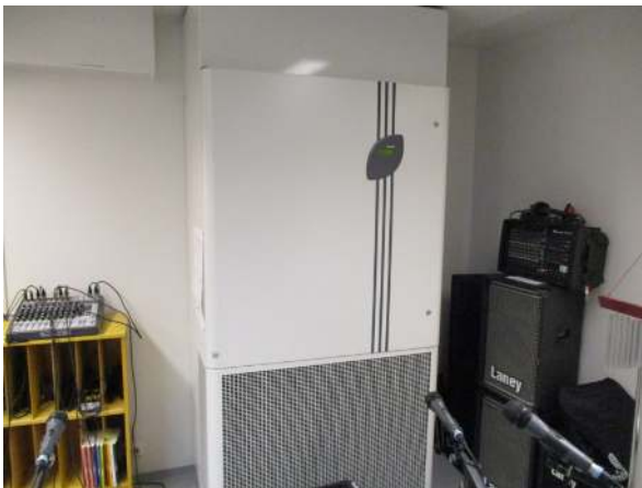
114. Koulukäyttömuutoksissa lisätty ilmanvaihtokone
