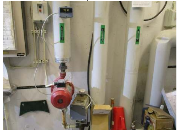
72. Patterilämmitysverkoston jälkisäätöryhmän pumppu
