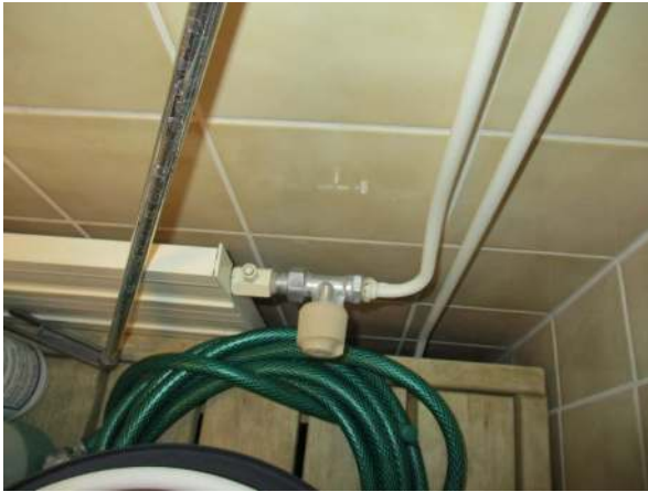
95. Lämminvesikiertoverkostoon (Lvk) on liitetty joitakin pattereita
