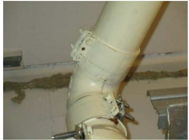
97. Valurautaisella kulmaosalla halkeama
