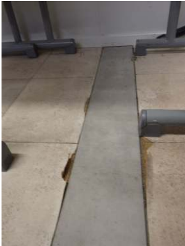
58. Luokkahuoneen lattiapintamateriaalissa pinnoitteen irtoilua.
