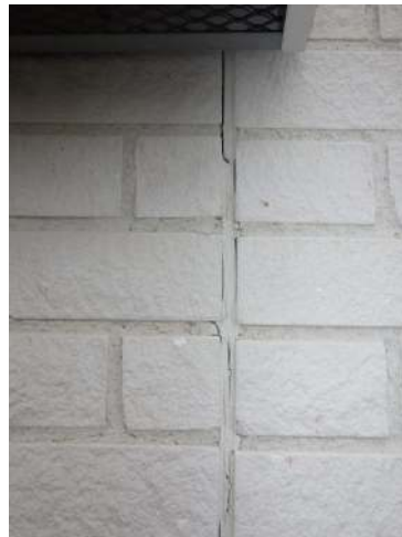
24. Julkisivu saumaus irti
