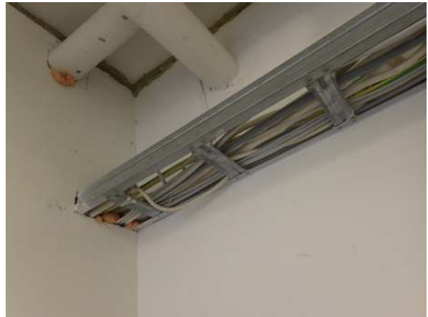
141. Väärin tiivistettyjä läpivientejä lämmönjakuhuoneessa.
