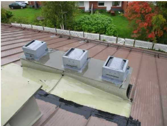
110. Alkuperäisrunkoisia poistoilmakoneita vesikatolla
