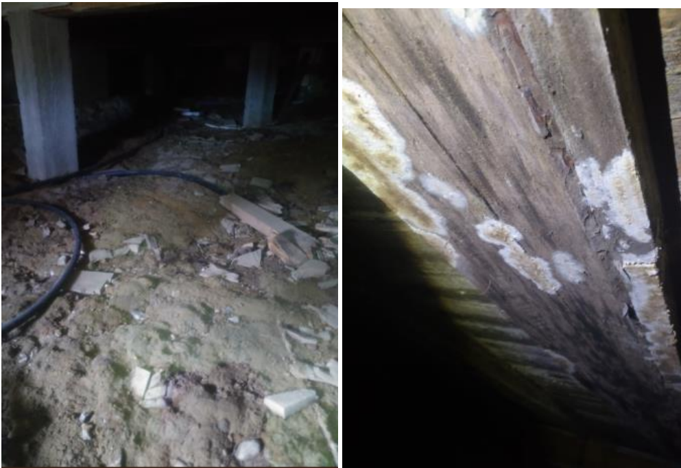
Kuvat 6 ja 7: Ryömintätila oli muuten siisti, mutta se oli kostea. Rakenteissa näkyi sienikasvustoa, kasvustoa oli havaittavissa lähes koko ryömintätilan alueella.
