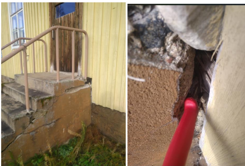
Kuvat 22 ja 23: Puurakenteessa kiinni oleva betoniporras lahottaa seinärakennetta. Puukko painuu vaivatta lahoon puuhun.
