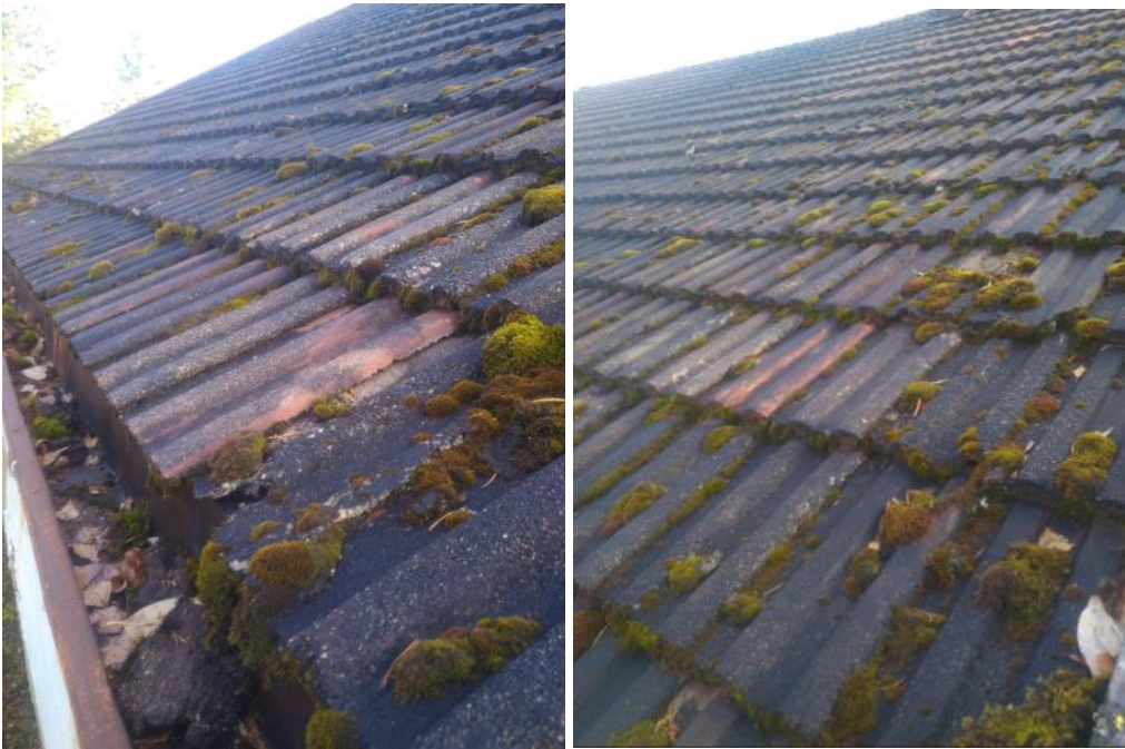
Kuvat 10 ja 11: Vesikate on tullut käyttöikänsä päähän. Katto vuotaa ja tulee korjata heti.
