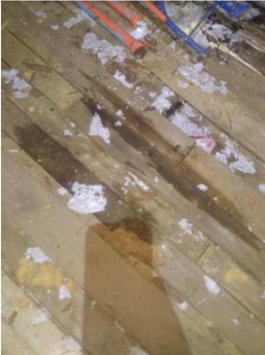
Kuva 17: Mikrobinäyte nro 8 otettiin märkien lautojen alta.
