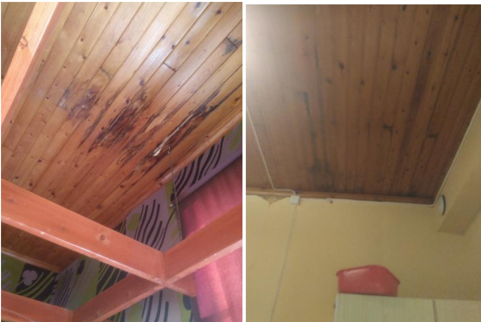
Kuvat 15 ja 16: Vesikaton vuotojälkiä on havaittavissa myös oleskelutilojen katossa. Vesi on kastellut rakenteen.
