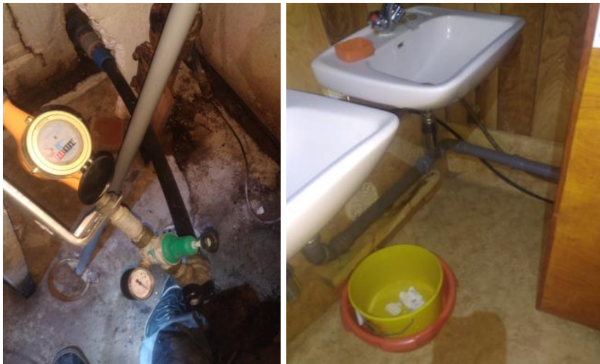
Kuvat 25 ja 26: Putket ovat vanhoja ja käyttöikänsä päässä.
