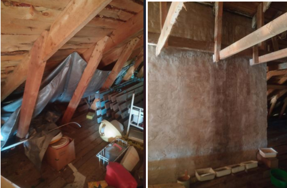
Kuvat 13 ja 14: Vesikate vuotaa ja vuotojäljet ovat havaittavissa käyttöullakon rakenteissa. Piipunläpivienti vuotaa, vuotovesiä on kerätty astioihin piipun juureen.
