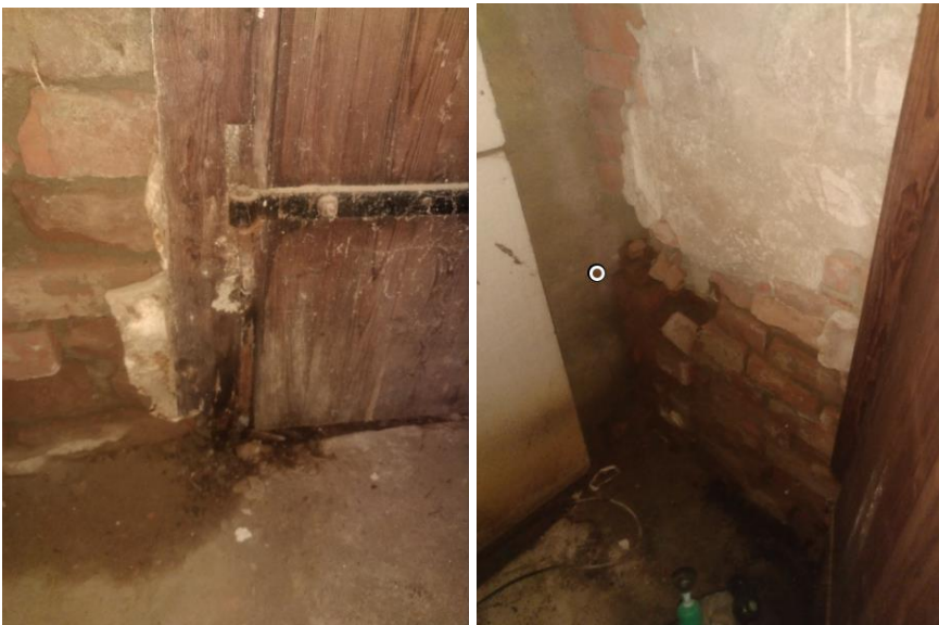
Kuvat 8 ja 9: Kellarin lattia oli silmin nähden kostea. Kosteus pääsee nousemaan kellarin lattiaan ja myös seiniin.
